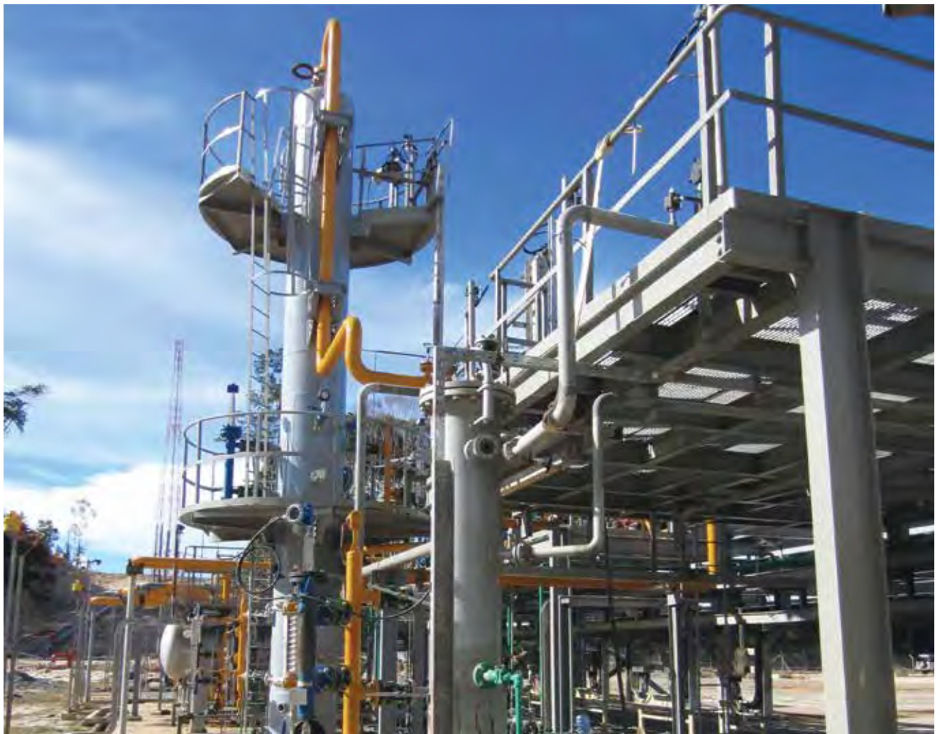
Fasilitas pemrosesan gas dengan kapasitas produksi 25 MMSCFD di Blok Simenggaris, Kalimantan Utara Gas processing facility with a production capacity of 25 MMSCFD at the Simenggaris Block, North Kalimantan
